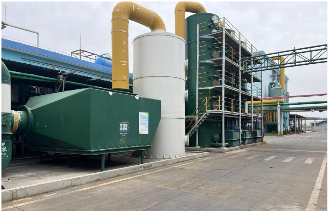
图 7.1-5 DA001 末端活性炭吸附装置现状照片
