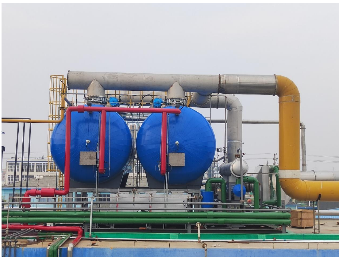
一级活性炭吸脱附装置现场照片
