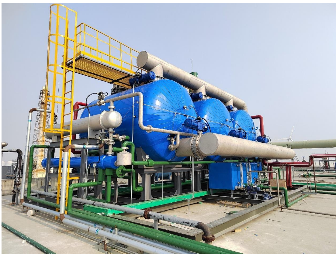
二级活性炭吸脱附装置现场照片
